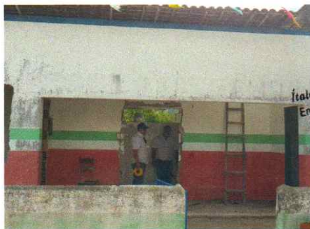
Foto 5 - Visão externa do PSF Riacho de Pedra Demolições e retirada de esquadrias
