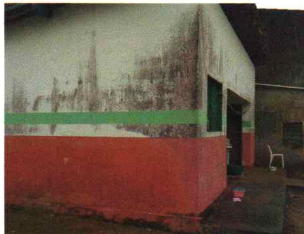
Foto 2 - Visão externa do PSF Riacho de Pedra antes do início dos serviços
